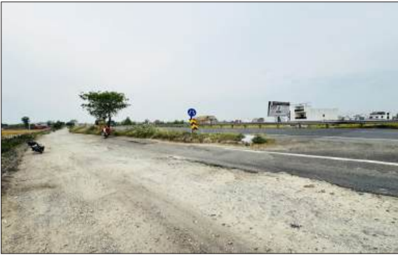
टूटी पड़ी सड़क।
