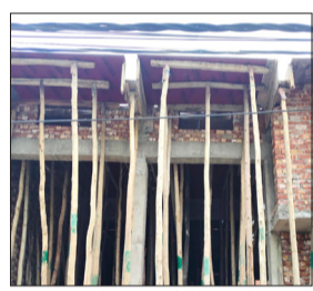
सम्राट अशोक नगर में बेसमेंट के साथ काराया जा रहा अवैध निर्माण।
