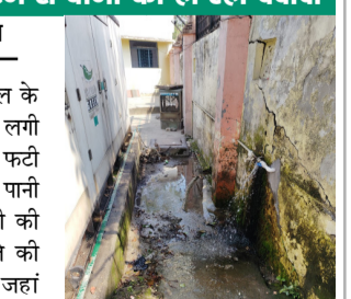
जनरेटर रूम के पीछे लगी पाइपलाइन से बह रहा पानी।
