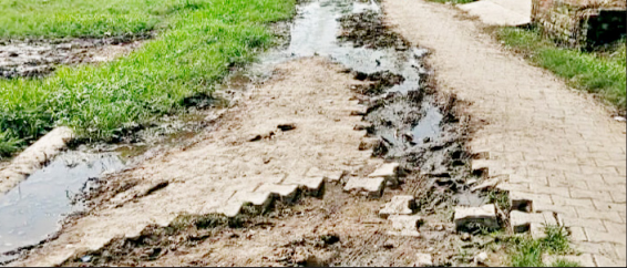
टूटी पड़ी सड़क।
