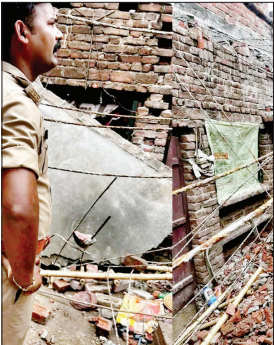
निर्माणाधीन मकान का लिंटर गिरने के बाद पड़ा मलबा। -जागरण मोर्चा
