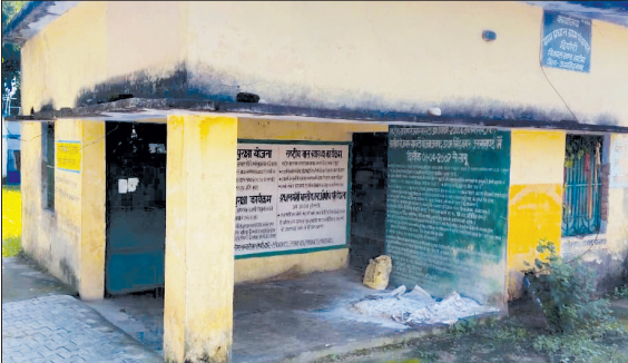
वर्ष 2001 में बने ग्राम देवरी का जर्जर पंचायत भवन। -जागरण मोर्चा
